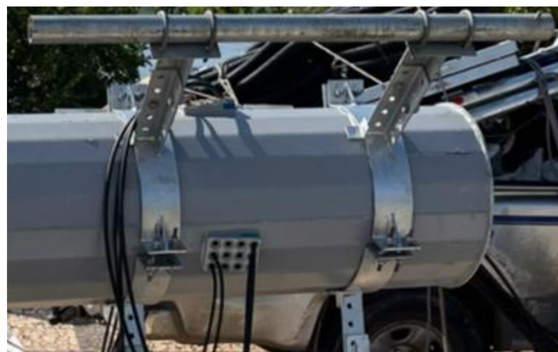
Sistema de passagem de cabos dos suportes externos
