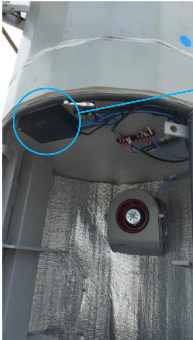
Placa de Controle Compartimento de Bateria
