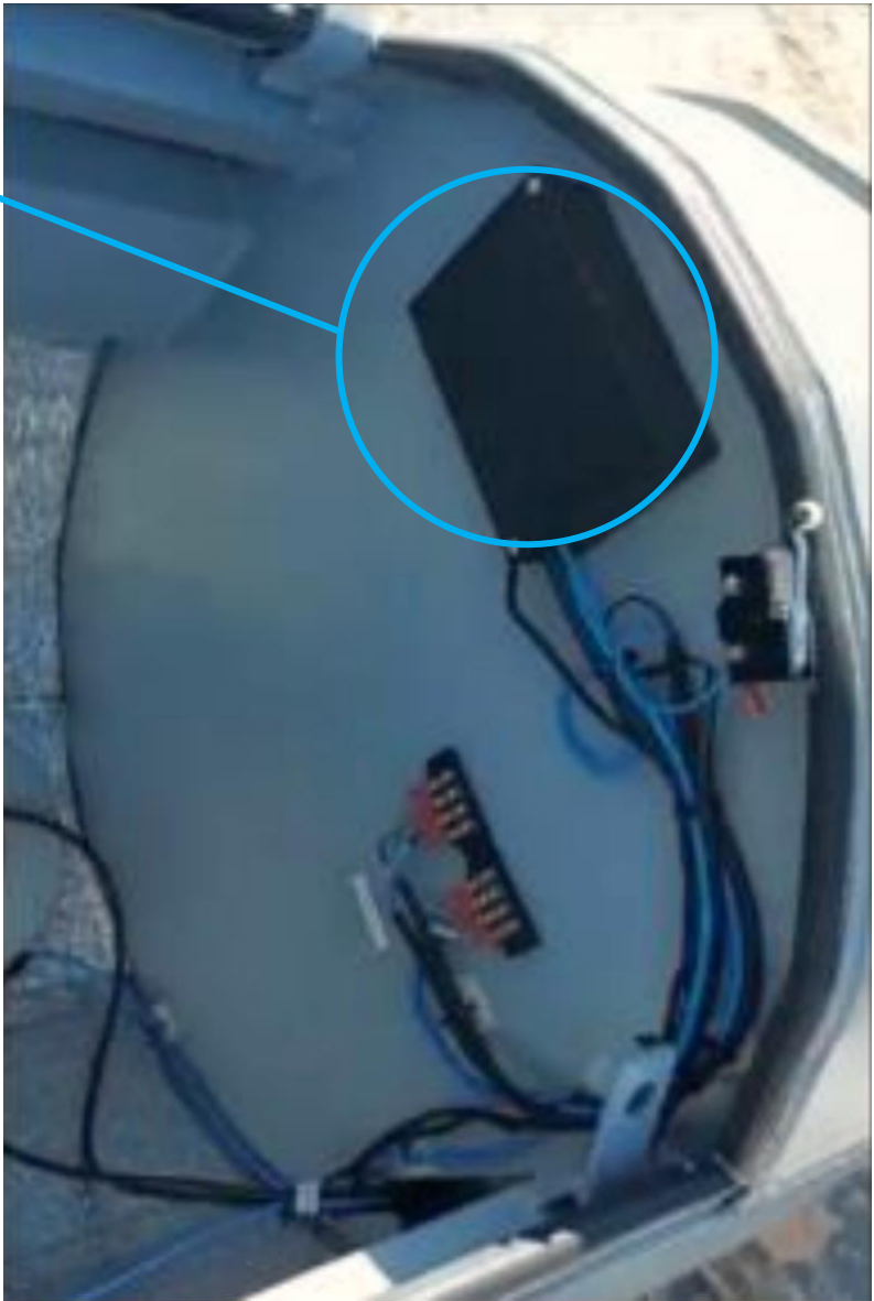
Placa de Controle Compartimento de RRU's
